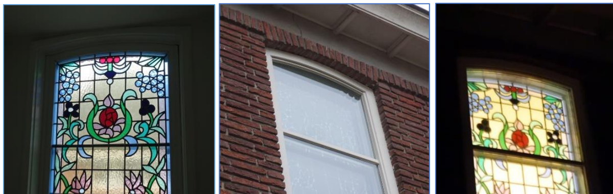
Figuren 11. Links: GiL overdag van binnenuit. Midden: Overdag van buiten. Rechts: 's nachts van buitenaf gezien met verlichting binnen. Dit is een vaste isolatieruit met binnen het GiL-raam in een eigen frame.
