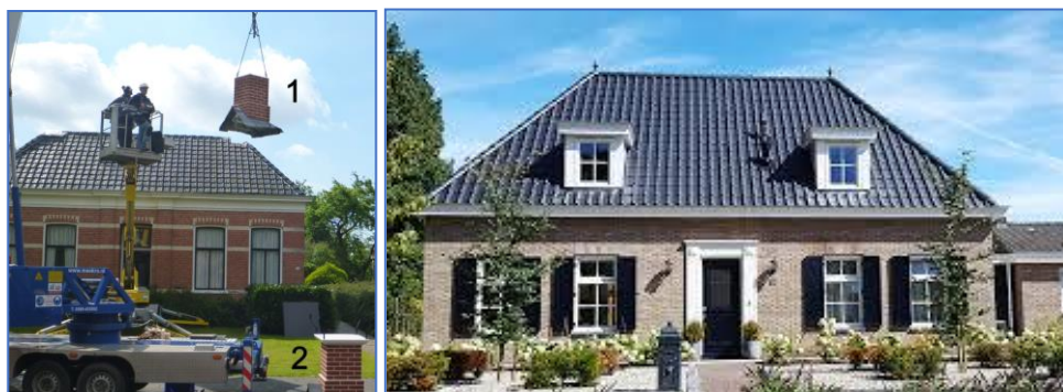
Figuren 46. Het vervangen van schoorstenen door lichtgewicht model of het verwijderen werd niet gezien als versterking, maar dat was het wel.
