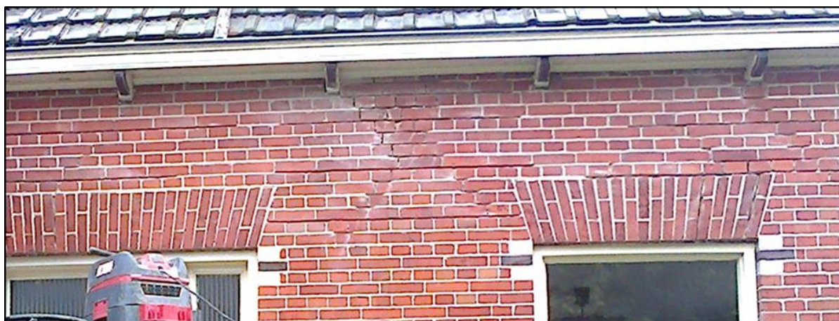
Figuur 65. Hier is duidelijk te zien dat de geplande lintvoeg wapening NIET doorloopt. Tussen de uiteinden van de ingelijmde wokkelwapening zal bij een nieuwe soortgelijke beving de muur weer scheuren. FOUT.
