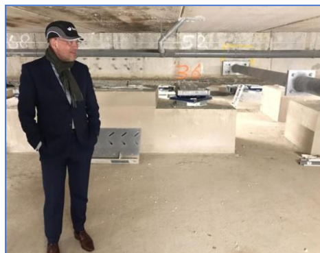
Figuur 71. Base-isolation onder gemeentehuis Loppersum met burgemeester Hans Engels. De grote afstand tussen de elementen en de extra versteviging met horizontale koppelingen tussen de balken is hier zichtbaar. Dit zijn geen betaalbare systemen voor duizenden bakstenen woningen die door kleine aannemers kunnen worden gerealiseerd. Foto: Dagblad van het Noorden.
