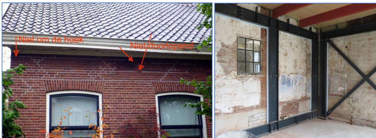
Figuren 41. In de praktijk werd alleen licht muurherstel toegepast bij woningen (links), zonder seismisch versterken. Door verkeerde toepassing zit er dan bij de volgende schok weer een nieuwe scheur in. Een heel groot verschil met de paar testwoningen die werden versterkt met een platformfundering (foto rechts) en overeenkomstig met de NPR dreigingskaart 2015 met inwendige stalen portalen in twee richtingen tegen zeer hoge kosten versterkt (> 150% - 200% woningwaarde). Het contrast kon bijna niet groter zijn.
