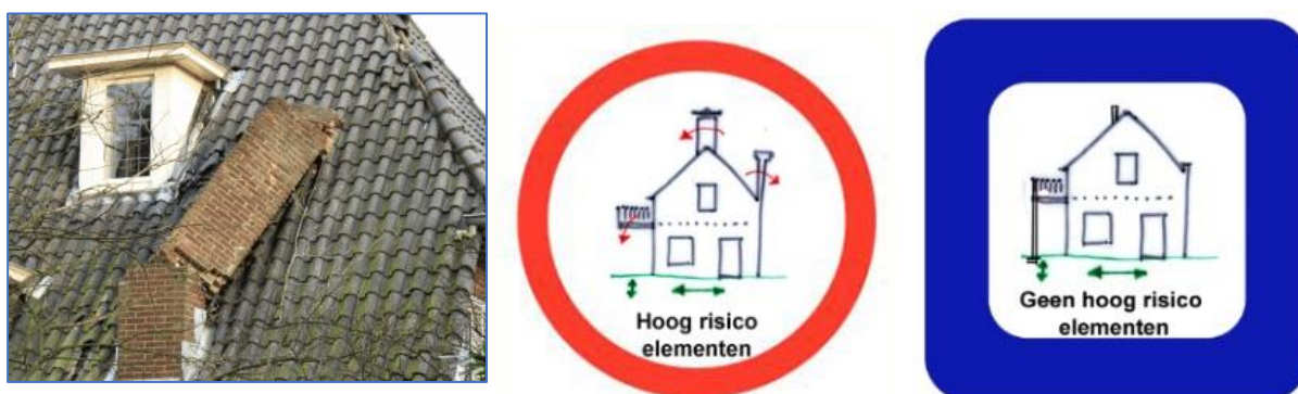
Figuren 1-64. Hoog-risico-elementen zijn bijvoorbeeld zware schoorstenen op een flexibele houten dakconstructie, balkons die zijn ingeklemd in bakstenen muren, en borstweringen of vrijstaande topgevels die op gebouwen en boven trottoirs zitten. Tijdens het vallen kunnen ze slachtoffers maken in de publiek ruimte.
