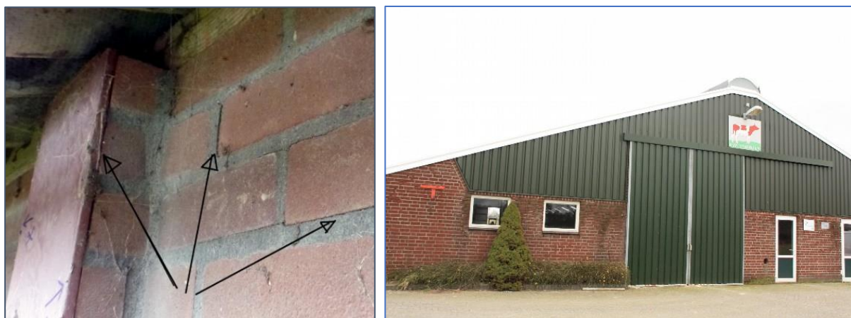
Figuren 1-49. Scheuren langs stalen kolom en baksteen invulmuur.
