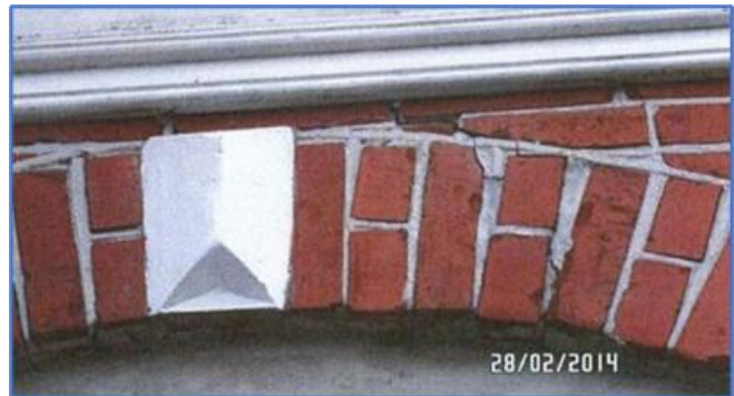
Figuur 22 Detailfoto van de bovenstaande afbeelding. De scheuren boven de ramen zijn niet structureel en kunnen verschillende oorzaken hebben. Bij nieuwe bevingen worden ze erger. Veel woningeigenaren ontdekten deze scheuren pas bij nader onderzoek van hun gebouw.
