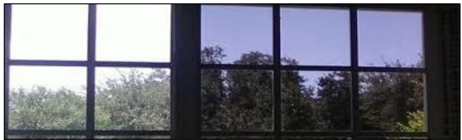
Figuur 31. Een warmte en zonwerende glasfolie buitenop zal de warmte spanning bij een extra \text{HR}^{++} ruit sterk verminderen. Bij alle ruiten de folie zal het niet van binnen zichtbaar zijn.
