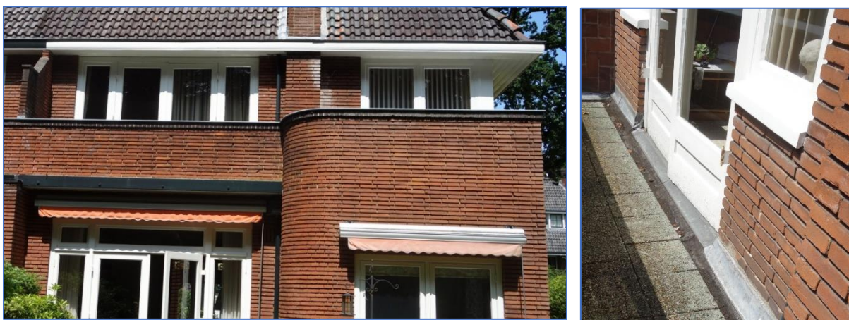
Figuren 3. Linker gedeelte boven de zonwering is met terrasdeuren boven de woon-eetkamer. Rechter gedeelte van het balkon is breder en boven de keuken, maar heeft geen terrasdeuren. Rechts : De onderdorpel van die terrasdeuren zit vlak op het bitumen van het balkonvloertje.
