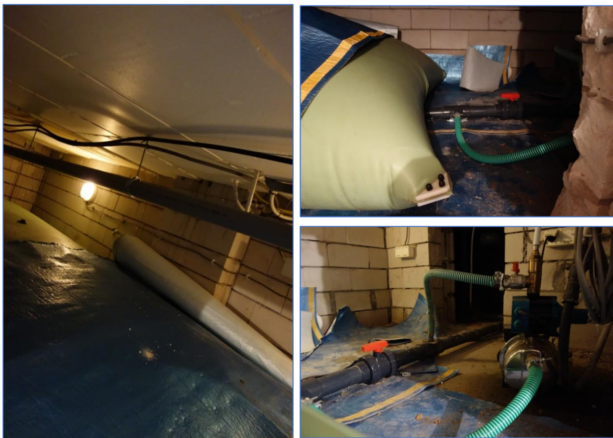
Figuren 40. Regenwater opslag in een hoge kruipruimte. Rechts onder de pomp.
