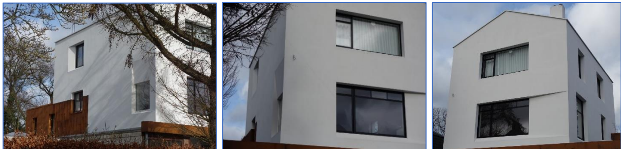
Figuren 13. Foto's zij-afschuining van negge, boven afschuining en brede zij-afschuining. Op deze foto's is ook te zien dat het dak overstek bijna geheel verdwenen is en de goot óp de isolatie ligt.
