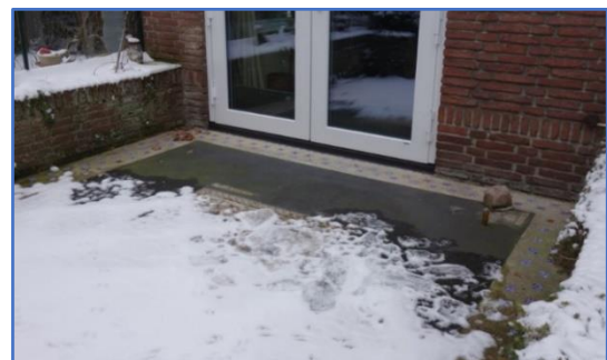
Figuur 5. Hier is te zien dat er veel warmteverlies naar buiten is door de convecto bak en de fundering onder het terras. Ook is er sprake van warmtestraling van de ruiten en muur boven het terras. De sneeuw smelt het eerste waar de temperatuur een graadje hoger is dan verder van het gebouw vandaan.
