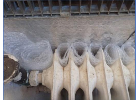
Figuur 6. Door het plaatsen van rollen bubbelfolie tussen de lamellen en de buitenmuur wordt de warmte afgifte aan die zijde verminderd.
