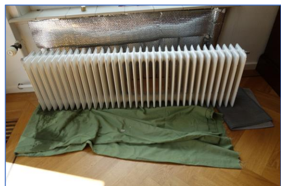
Figuur 15. Draineren van de leidingen van het CV-systeem en loskoppelen van de radiator en verwijderen radiatorfolie. Bij het terugplaatsen van de radiator is het verstandig om voetventielen te plaatsen. Ook kan ervoor gekozen worden om een convector radiator te plaatsen wanneer er straks een warmtepomp moet komen zonder LTV-vloerverwarming. Deze 140 cm x 40 cm radiator heet een vermogen van ongeveer 600 Watt bij hoog temperatuur water.
