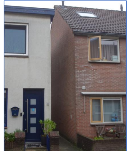
Figuur 24. Bij veel tussen doorgangen tussen rijtjeswoningen is er onvoldoende breedte om voor een of twee woningen buitenzijdige muurisolatie toe te passen. In dat geval is binnenzijdige isolatie de optie. Bij de linker (witte woning) loopt de trap omhoog langs de buitenmuur en kan niet met 5 tot 10 cm smaller gemaakt worden.
