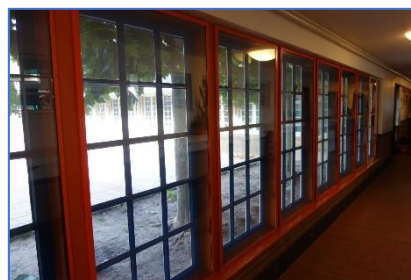
Afbeelding 15. Binnen achterzetramen zullen de isolatiewaarde van de gehele constructie (inclusief glaslatten) aanzienlijk verbeteren. Bij deze school zijn grote achterzetruiten van Acrylaatplaat gezet die door de luchtlaag een drieboudige isolatie leveren ten opzichte van enkel glas.
