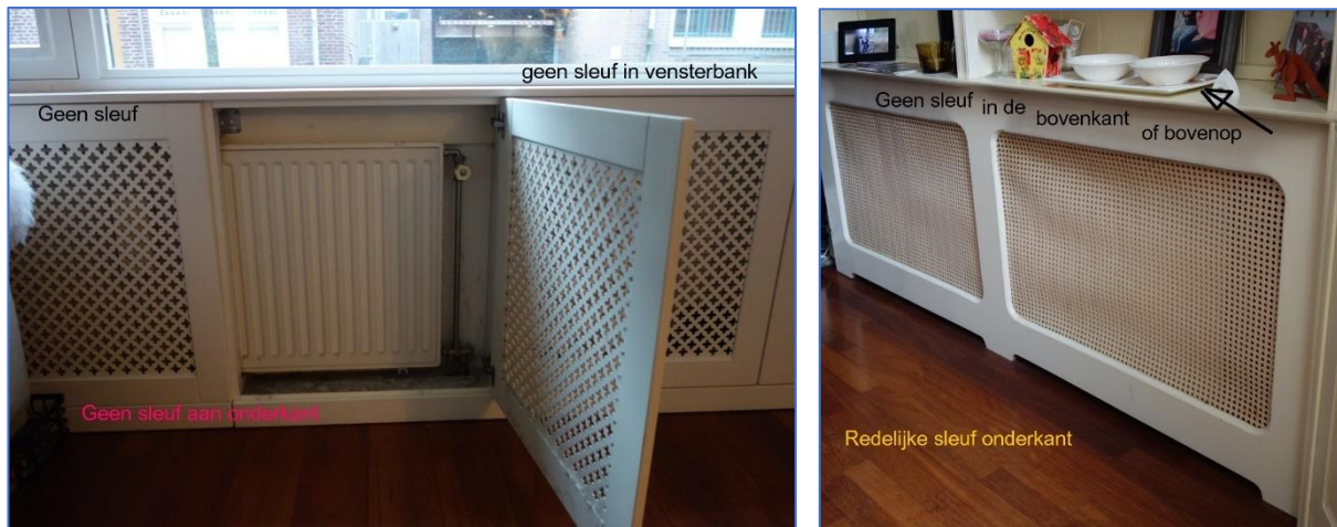
Figuren 10. Links : de grille-deurtjes kunnen open, maar door de plint is er aan de onderkant geen opening (te verwijderen). Door de deurtjes aan de bovenkant 4 cm in te korten kan een goede sleuf gemaakt worden. Rechts : De panelen zitten vast. Aan de bovenkant kan de warme lucht er niet uit. De straling verwarmt de grille en slechts de grille geeft wat convectie en stralingswarmte af naar de kamer.
