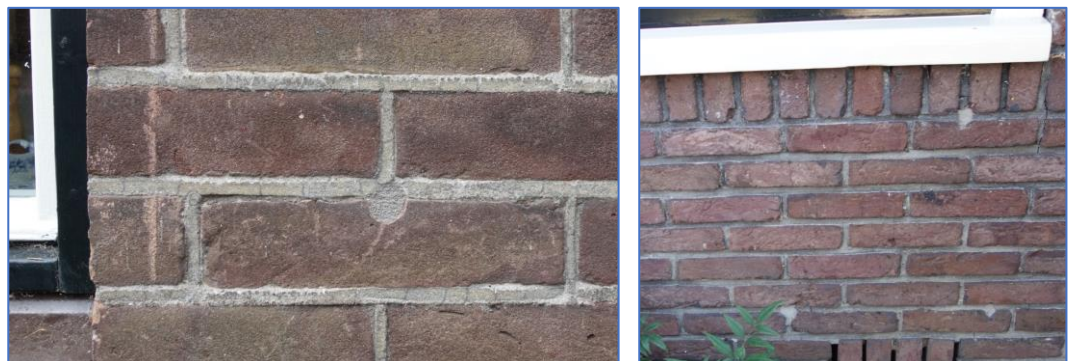
Figuren 24. Voorbeelden van een te grote boordiameter en een verkeerde kleur invulmortel.
