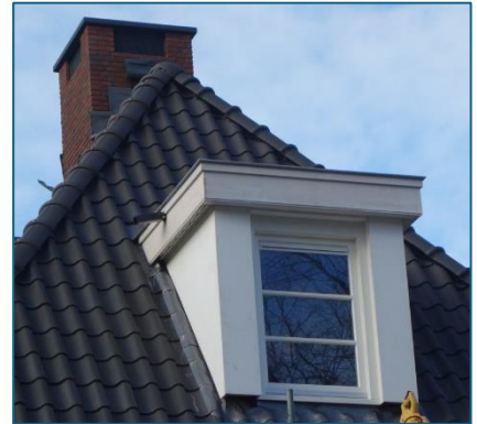
Figuur 20. Recent opgeleverde dakkapel met dik dak (Rc 6,3 = nieuwbouwnorm) en zijkanten (Rc 4,7). Volgens de bouwnorm hoeven de zijkanten van dakkapellen slechts een isolatiewaarde te hebben zoals een paneel in een kozijn of Rc 1,65. Dat is behoorlijk laag en niet aanbevolen.
