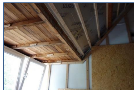
Figuur 6. Bij het binnenzijdig isoleren van een dakkapel kan er onvoldoende hoogte zijn, de ramen te dicht tegen het plafond aan zitten en de dakbalkjes te dun zijn om 15 cm isolatiemateriaal ertussen te krijgen. Bovendien zullen de balkjes dan als thermische bruggen werken als er bovenop geen extra isolatiemateriaal is. De binnenzijde moet aan de warme zijde een dampremmende laag hebben.
