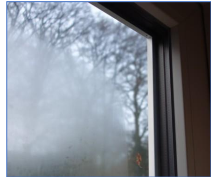
Figuur 6. Buitenzijdig condens op een goede Tripleglas ruit (Rg = 2,0) in de herfst (kale bomen). Langs het kozijn treedt hier geen condens op omdat het kozijn en de glas afstandshouder (spacer) een iets mindere isolatiewaarde hebben dan het glas. Deze condens verdwijnt na enige tijd.
