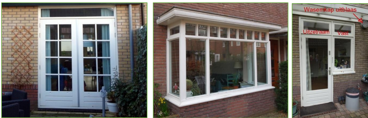
Figuren 26. Links : Oude stolpdeuren, vervangen door isolatieglas deuren met een vast bovenlicht, geen ventilatie openingen en ook geen balansventilatie systeem.
