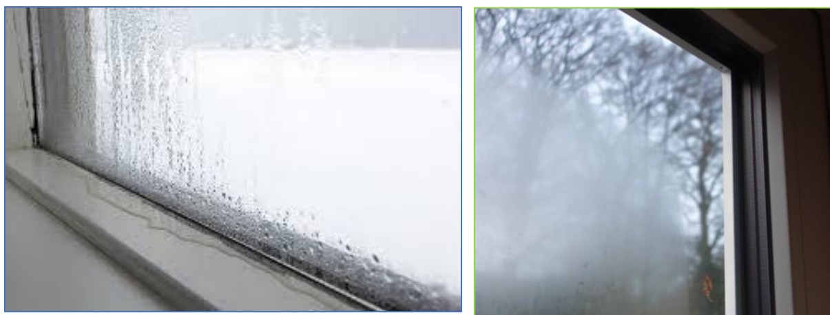
Figuren 45. Links . Condensatie aan de binnenkant van oud dubbel glas en enkel glas. Het vocht druipt langs het raam naar beneden. Als dit tussen het glas en het hout komt kan er rot optreden. Schilderwerk moet 2 mm doorlopen tot op het glas. Rechts . Tripleglas met dauw op de buitenkant van de ruit. Dit is een teken dat de ruiten goed isoleren 😊. Na enige tijd verdwijnt deze dauw.
