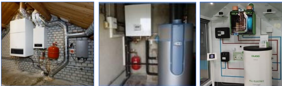
Figuren 30. Links. Hybride warmtepomp en de HR-Cv met rechts (grijs) de omvormer voor de PV. Midden. Voorbeeld van een Lucht-Water warmtepomp binnen opstelling met een buffervat. Rechts. Ducobox Eco met buffervat om koude-pieken op te vangen.
