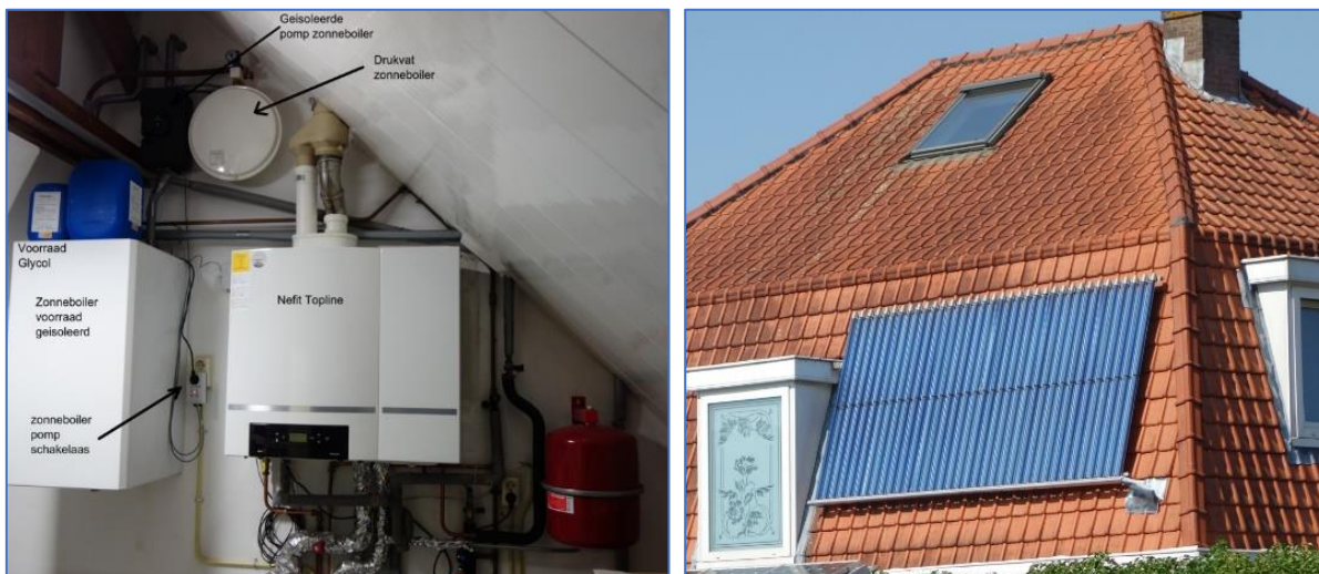
Figuren 26. Een zonneboiler (vacuüm-tube) genereert over een jaar ongeveer 50% van de tapwater warmte, maar weinig in de winter. Links de geïsoleerde opslagtank. De ronde tank bovenin is de druktank. Daarnaast is de zwarte circulatiepomp. Tussen de opslagtank en de HR-Cv is de stroomschakelaar. Wanneer de temperatuur in de zonneboiler hoger is dan in de opslagtank werkt de pomp.
