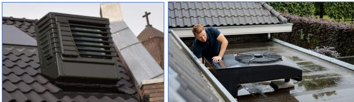
Figuren 34. Warmtepompen units op een schuin dak en de aanvullende apparatuur op zolder. Boven: Decorio. Bij een buitenunit op het dak moet voor onderhoud een monteur komen en zijn extra veiligheidsregels van toepassing. Er is ook de EQ-Air (26 dB, dus heel stil) en de Econex schuin dak unit. Rechts: Horizontale positie van een warmtepomp. Er komen regelmatig nieuwe modellen op de markt.
