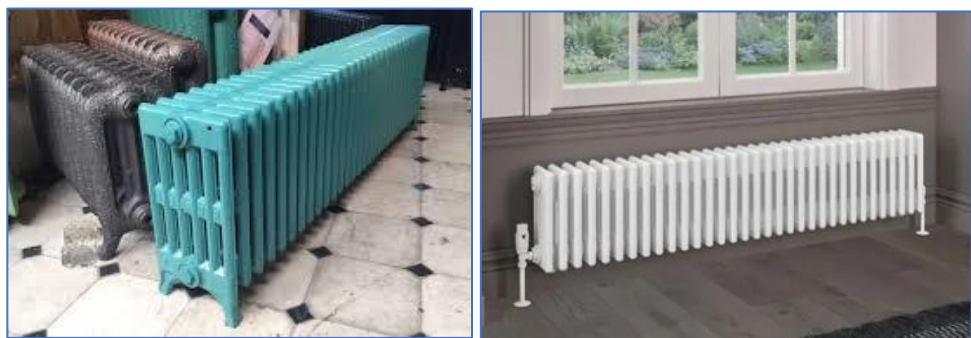
Figuren 24. Oude radiatoren hebben een groter watervolume dan plaatradiatoren. In monumenten kunnen deze radiatoren ook voor de verwarming dienst blijven doen wanneer de muren binnenzijde na-geïsoleerd zijn.
