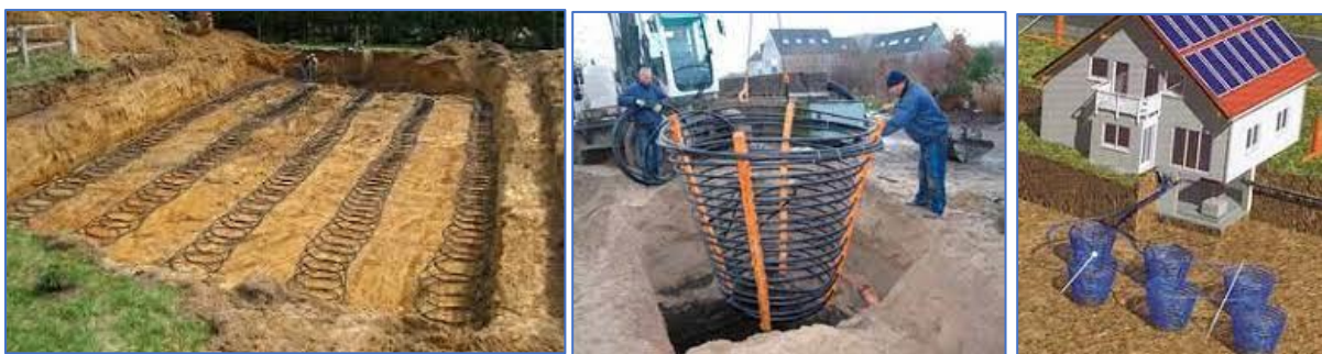
Figuren 6. Oppervlakte leidingen netwerk, leidingen korven en oplossing voor passief huis met kelderinstallatie. Mogelijk wanneer er zich binnen de 20 m geen andere oppervlakte netwerken bevinden.
