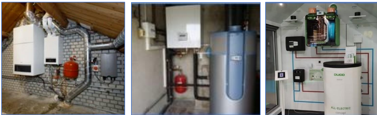
Figuren 26. Links. Hybride warmtepomp en de HR Cv met rechts (grijs) de omvormer voor de PV. Midden. Voorbeeld van een Lucht-Water warmtepomp binnen opstelling met een buffervat. Rechts. Ducobox Eco met buffervat om koude-pieken op te vangen.
