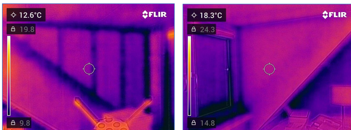
Figuren 24. Links . Hier zijn de regels van de matig-geïsoleerde zijkant van de dakkapel duidelijk zichtbaar als warmtelekken. De temperatuur tussen de regels is ongeveer 13° C en de regels ≈ 10°C. De donkerblauwe zone rechts is het raamwerk of kozijn dat ook niet isolerend is.
